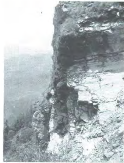
चित्र नं. १४ : पहिरोको पश्चिम तिर अस्थिर अवस्थामा रहेको चिरा युक्त चट्टान र भिरालो भूवर्णोट
